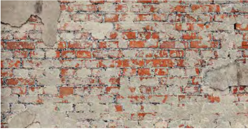
Esempio di supporto non adeguatamente ripulito
