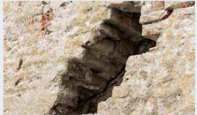
Esempio di lacuna muraria da ripristinare
