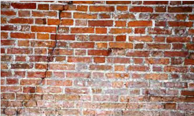
Esempio di muratura lesionata da ripristinare
